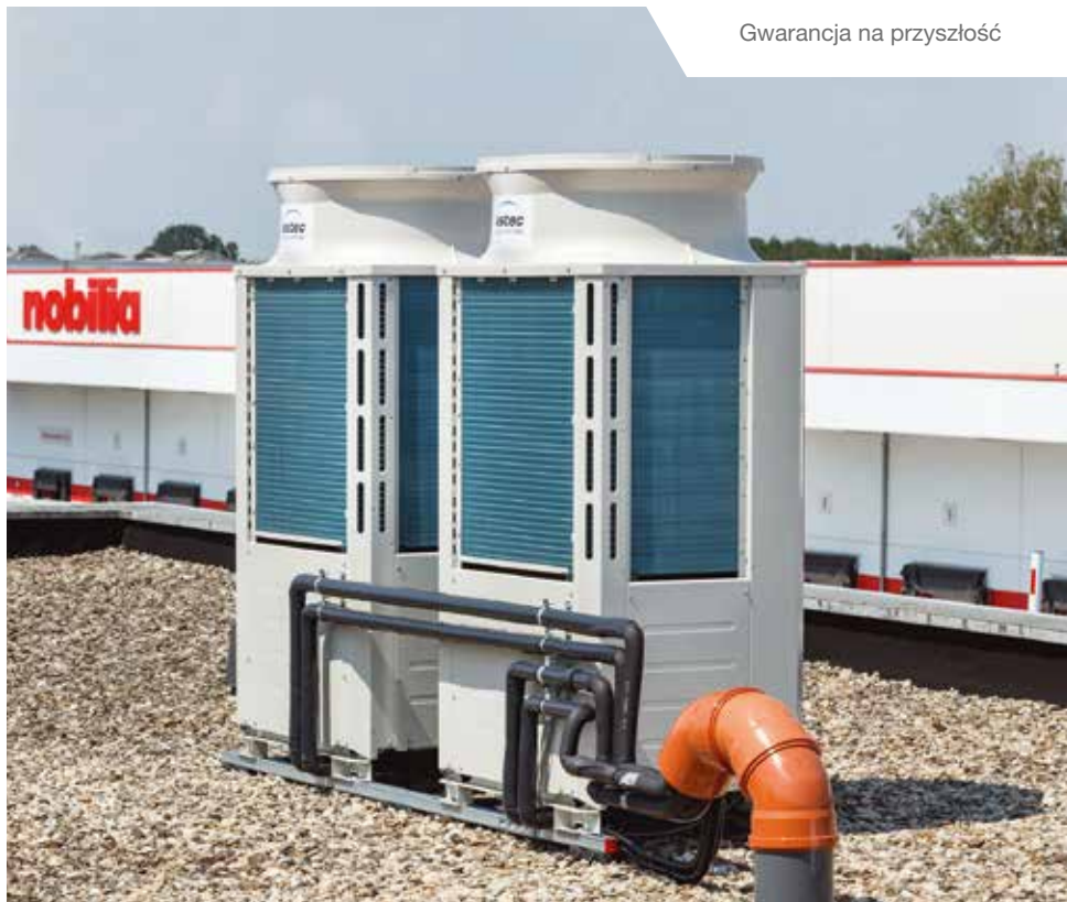
Płaski dach budynku biurowego nadaje się znakomicie do montażu urządzeń zewnętrznych. Stąd urządzenia City Multi VRF na obu piętrach zaopatrywane są w zimno i ciepło z dostateczną wydajnością.
